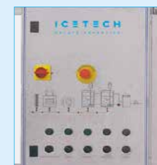
Quadro elettrico Elektrische tafel. Cuadro eléctrico.
